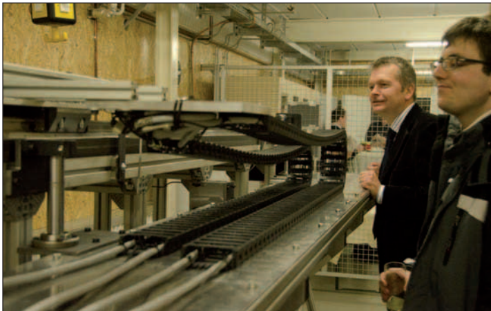
Abb. 6: Wahrscheinlich schnellste Schleppkettenanlage Europas ( a=30\text{m/s}^2 )
