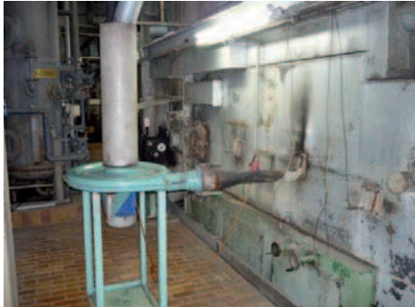
Abb. 2: Gebläse zur Einbringung der KF in die Braunkohlenfeuerung über die seitlichen Schauluken des Kessels
